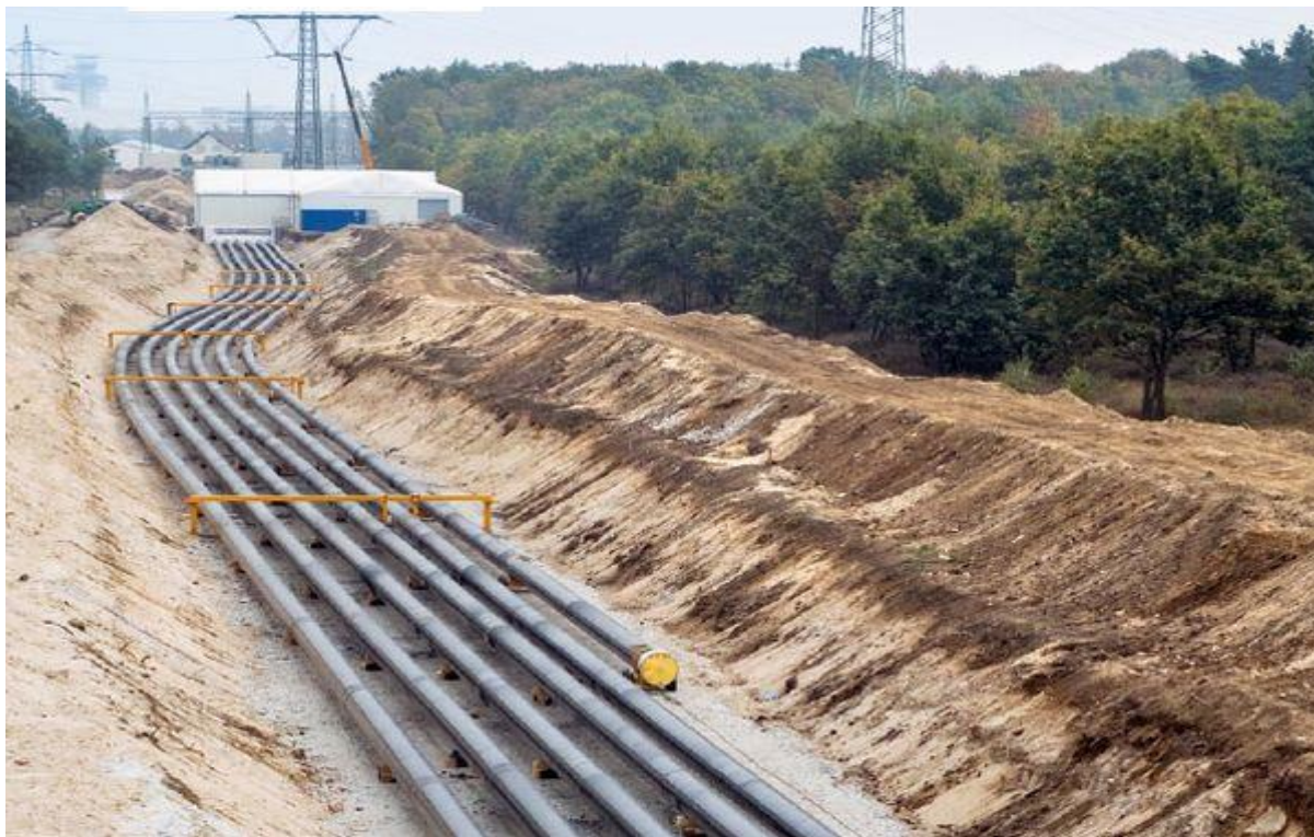
(Liaison enfouie, Kelsterbach ; Source : constructeur Siemens)
